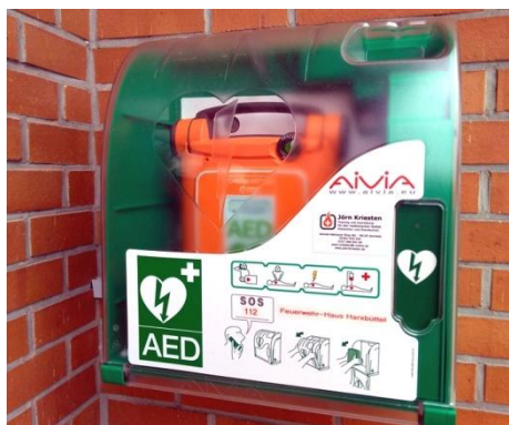
Ein „Defi“ der neuesten Generation am Feuerwehrhaus Harxbüttel
